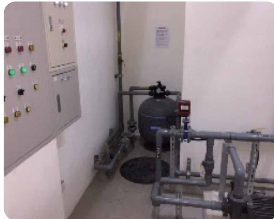
雨水回收儲存系統
